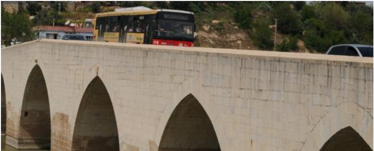
Görsel 15. Köprü Mansap Cephesi 6.,7.,8. Gözlerin Kemerlerinde Açılma ve Çatlaklar
