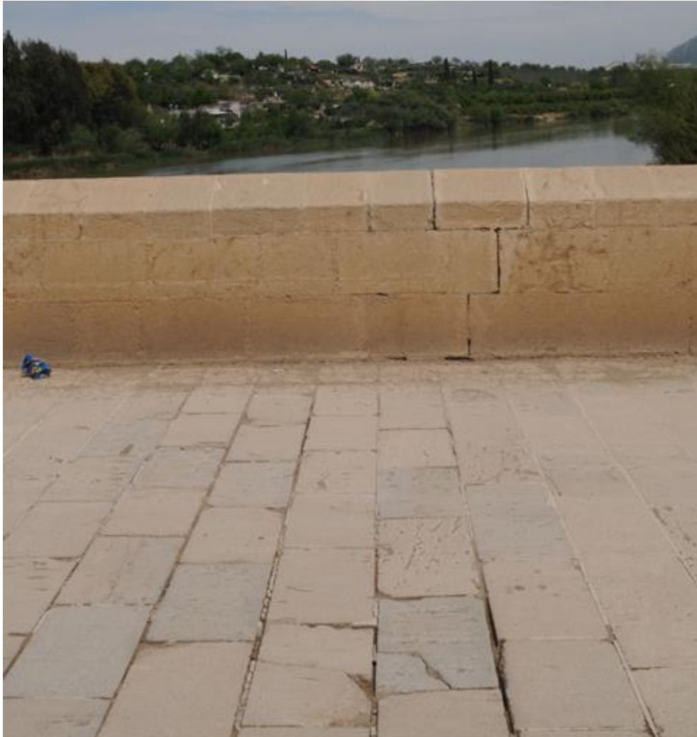
Görsel 11. Misis Köprüsü Korkuluk Duvarlarında ve Yol Kaplamasında Açılmalar
