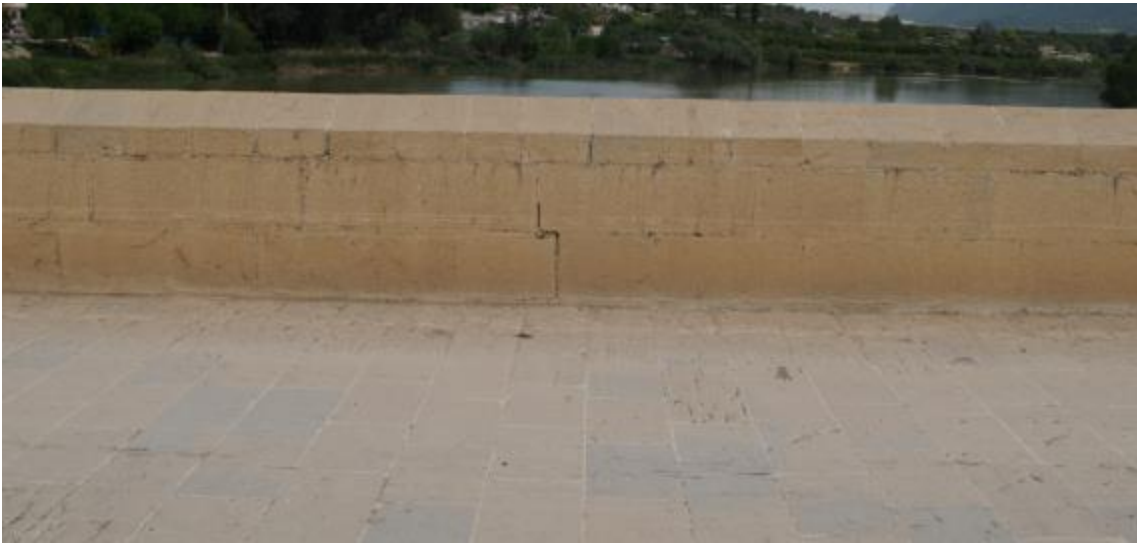
Görsel 17. Misis Köprüsü Korkuluk Duvarlarında Açılmalar
