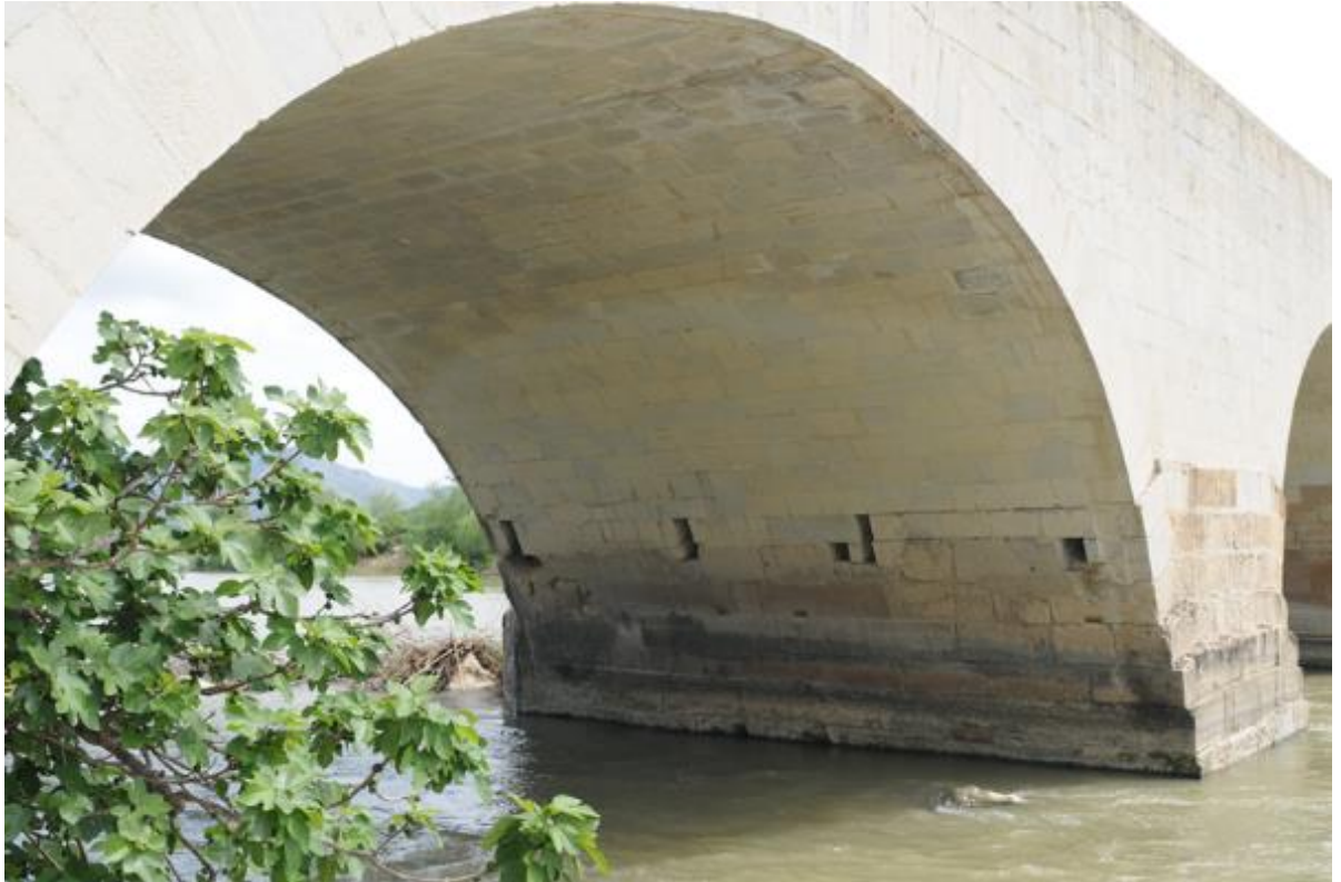
Görsel 9. Misis Köprüsü 2023 Mansap Görünüş, Köprü Ayağı 1. Göz Tonz Taşlarında Açılma
