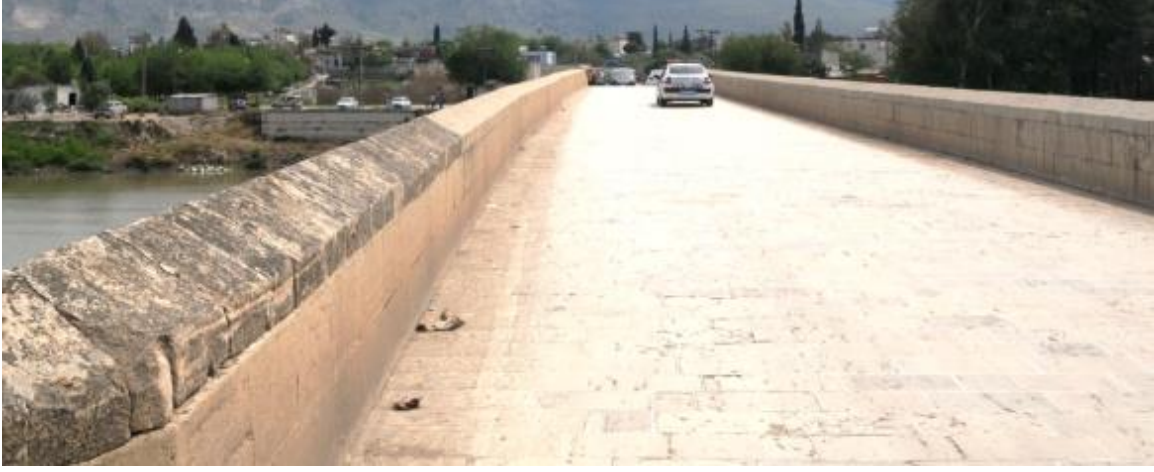
Görsel 12. Misis Köprüsü Korkuluk Duvarlarında Açılmalar
