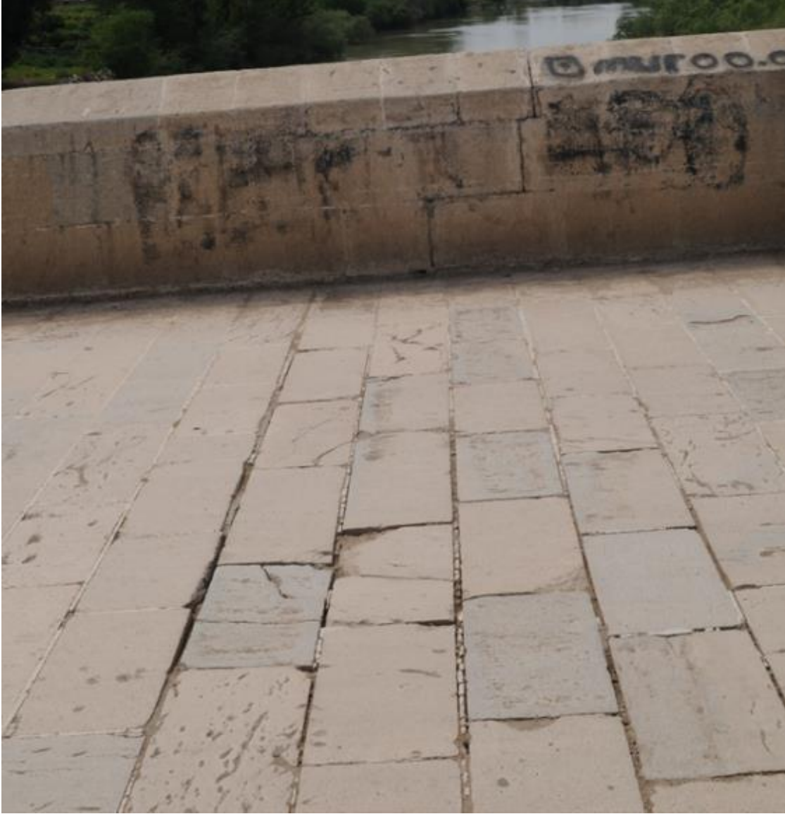
Görsel 16. Misis Köprüsü Korkuluk Duvarlarında ve Yol Kaplamasında Açılmalar
